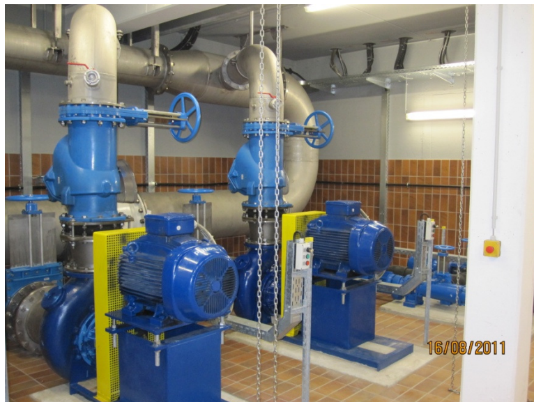
Abbildung 15: Tropfkörperpumpen Kläranlage S
